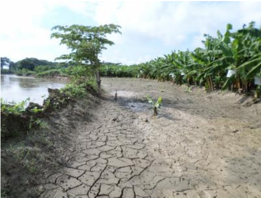
Eliminación total de la vegetación orillas del río, provoca inundación, ocasionando daños a la plantación de banano.
